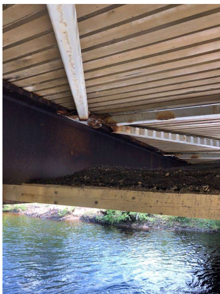
Korrosjonsskadet Iskurašjohka bru
